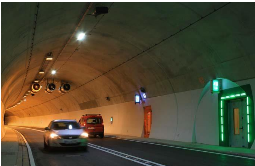
Abbildung 2: Technische Einrichtungen im Tunnel (Videoüberwachung, Rauchmelde- und Brandschutzanlagen, Belüftungsanlagen, Notrufanlagen, u.s.w.)
